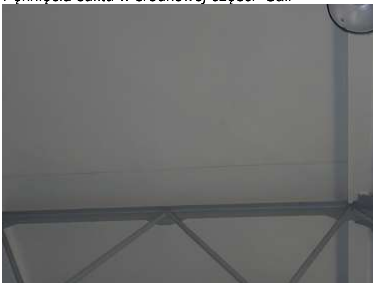
Pęknięcia sufitu w środkowej części Sali
